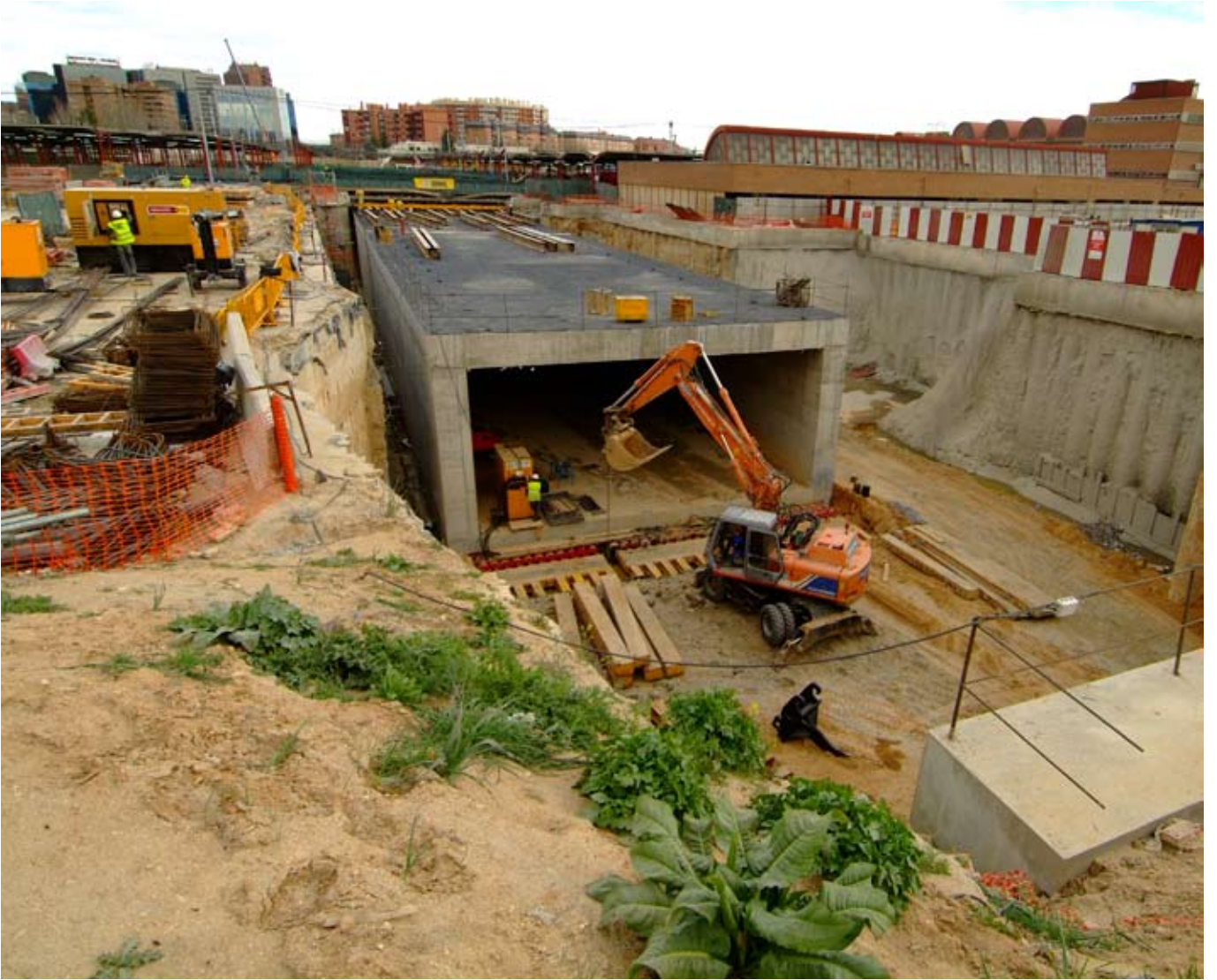
Imagen durante la ejecución de las obras. Túnel Sur Cajones Oeste. Marzo 2006
