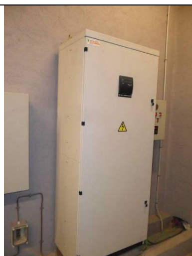
Batería de condensadores
