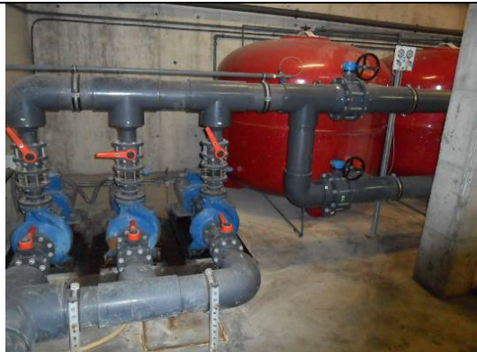
Depuración piscina cubierta
