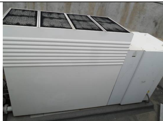
Torre enfriamiento de agua
