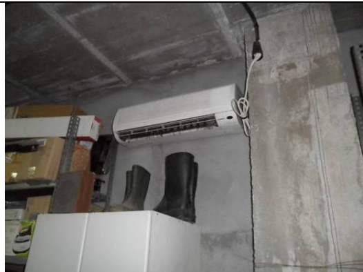
Equipo aire acondicionado
