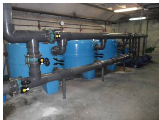
Bombas piscina de 25 m
