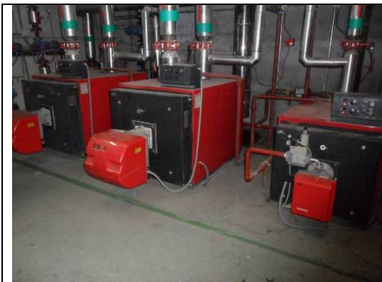
Calderas Pabellón y Piscina
