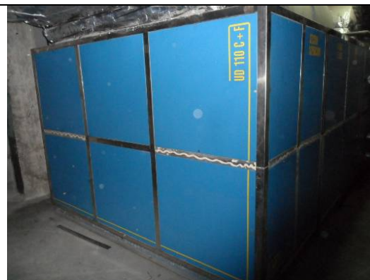
Deshumectadora Piscina Cubierta
