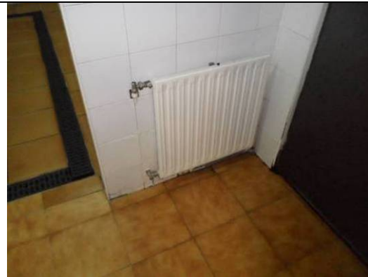
Radiadores de agua
