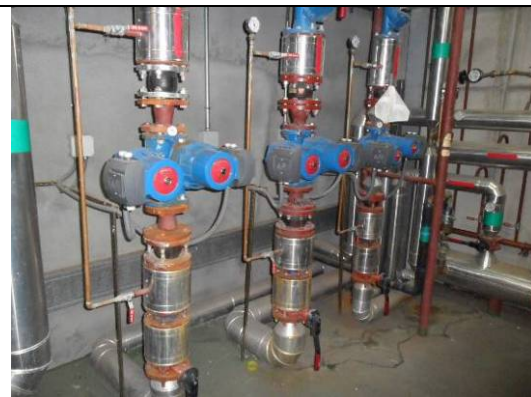
Bombas calefacción y acs. Pabellón y Piscina
