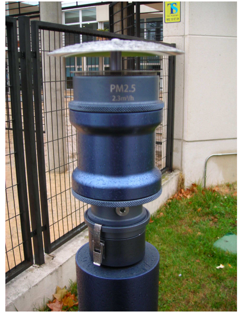
Detalle del mismo equipo
