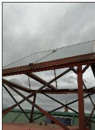
Ilustración 9. Paneles solares térmicos
