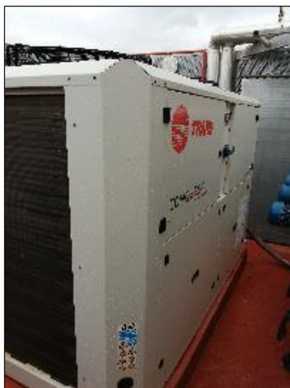
Ilustración 6. Bomba de calor
