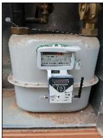
Ilustración 4. Contador gas natural
