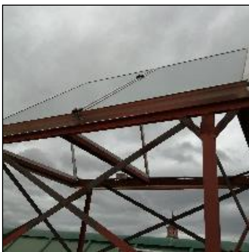
Ilustración 12. Paneles solares térmicos
