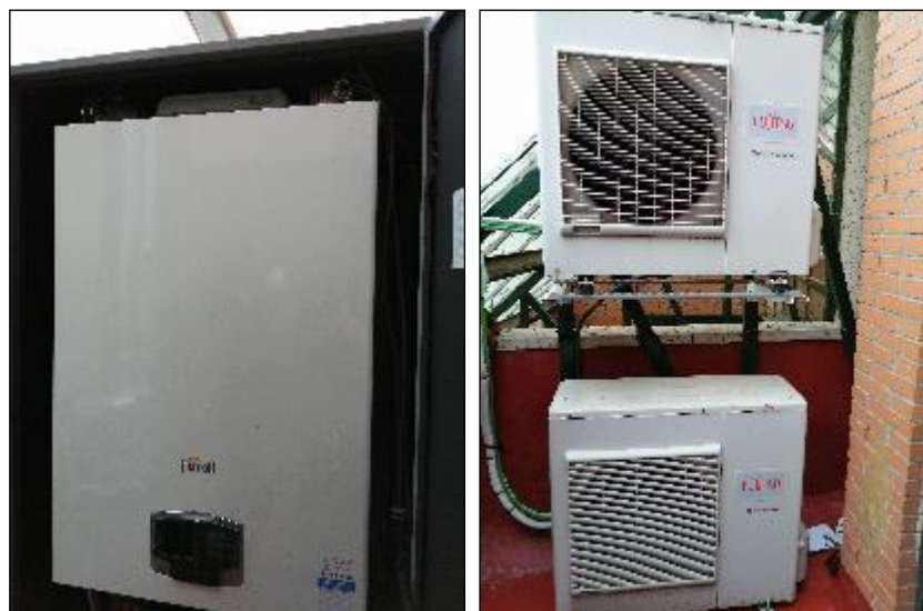
Ilustración 5. Caldera Ferroli y bombas de calor independientes
