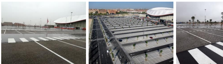
Figura 12. Pavimento permeable en el Estadio del Atlético del Madrid. Fuente: Ayto. de Madrid.
