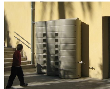
Aljibe en el colegio público Gozalbes Vera de Xàtiva (Valencia).
