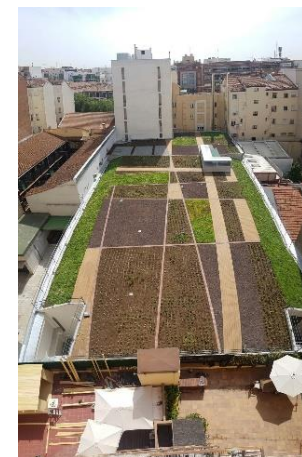
Cubierta vegetalada en el supermercado Mercadona de la C/ Bravo Murillo (Madrid). Fuente: Mercadona S.A.
