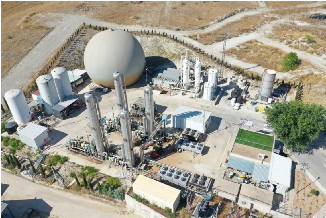
Planta de tratamiento de biogás
