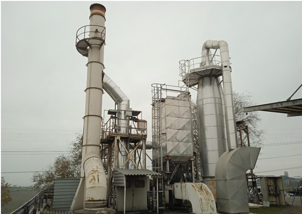
Planta de incineración de restos de animales muertos
