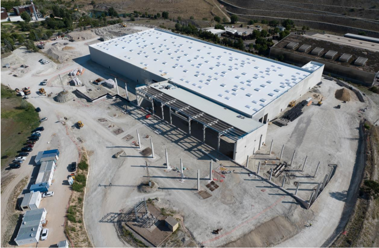
Cerramiento de compost, afino y tratamiento biológico
