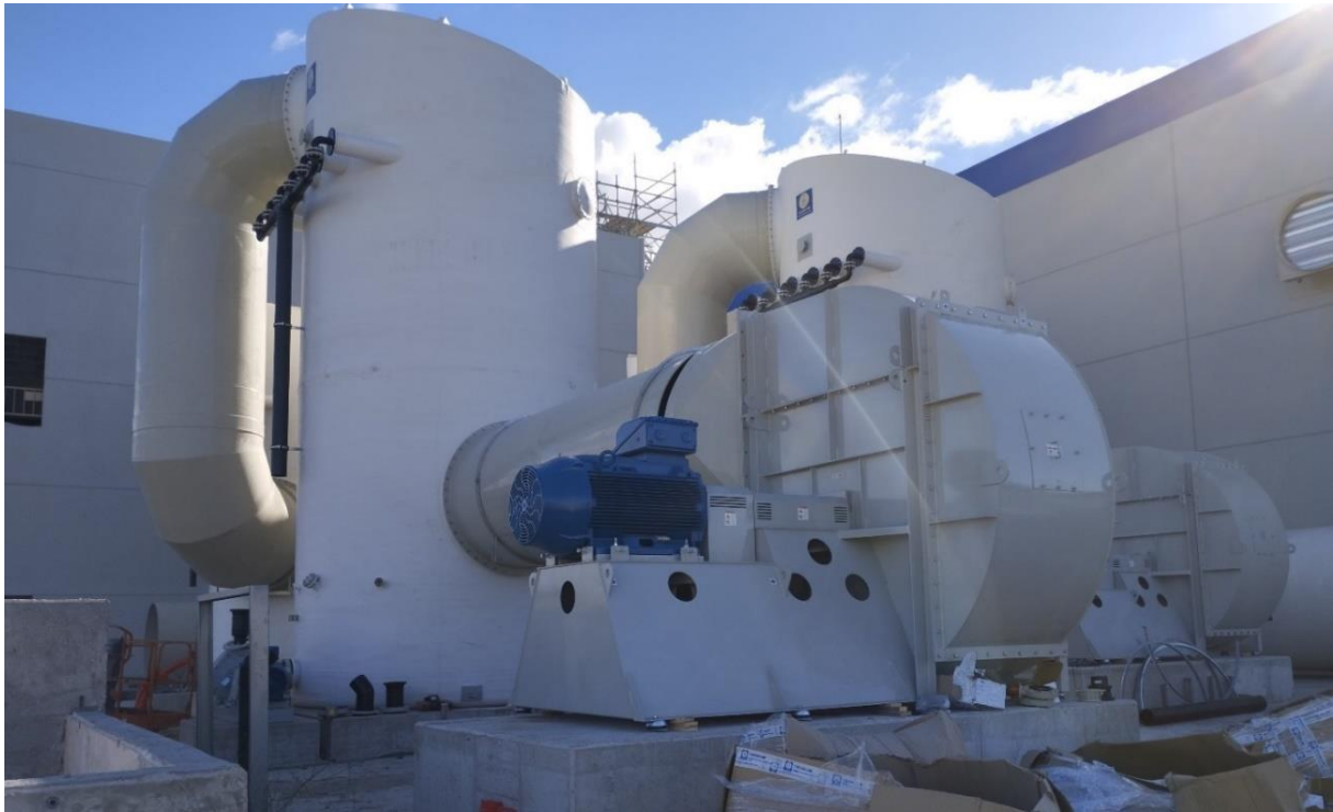
Tratamiento de aires.
