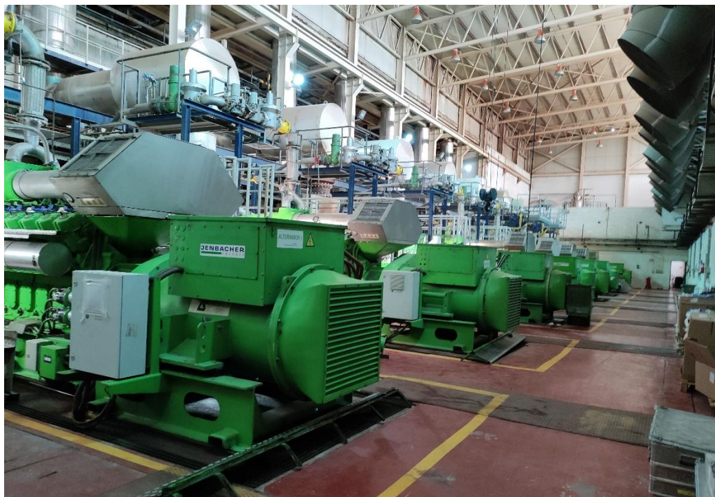
Motogeneradores de La Galiana
