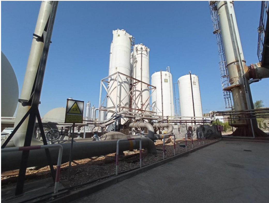
Tratamiento de biogás en La Galiana
