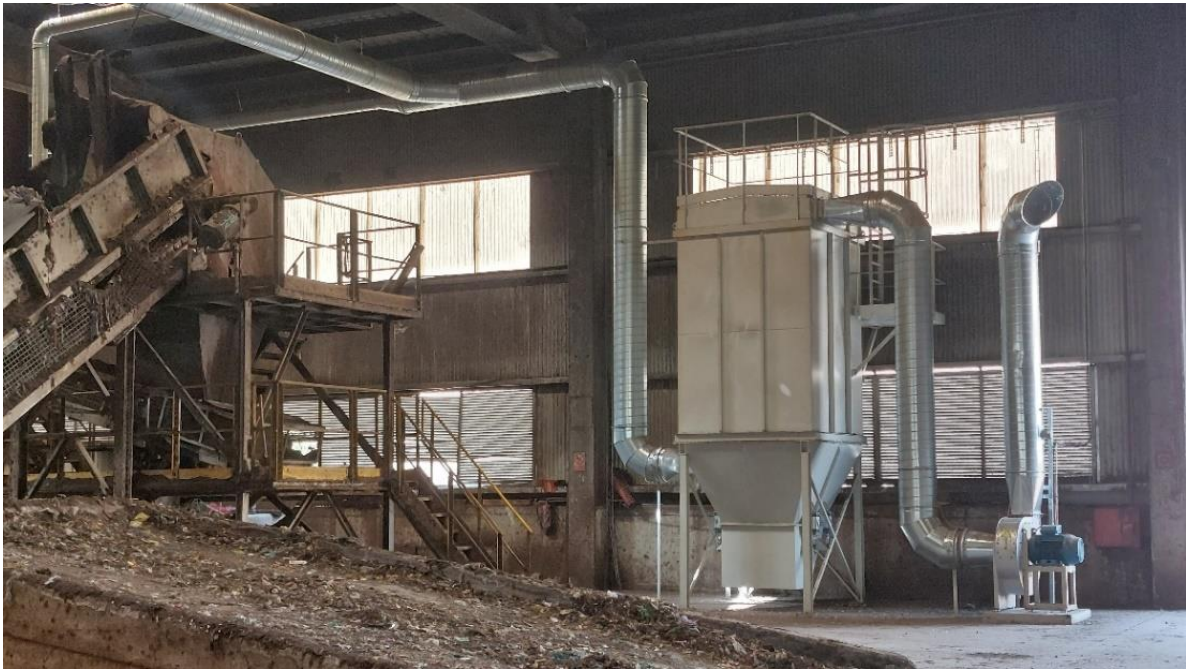
Nuevo filtro de partículas en la nave de afino de compost y material bioestabilizado en la planta de La Paloma
