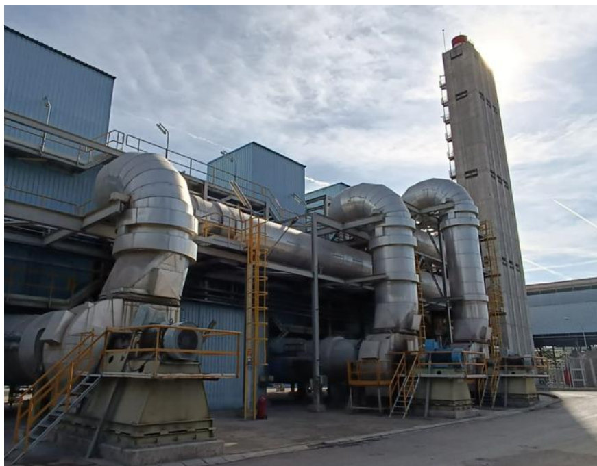
Chimeneas de Las Lomas (una por cada línea)
