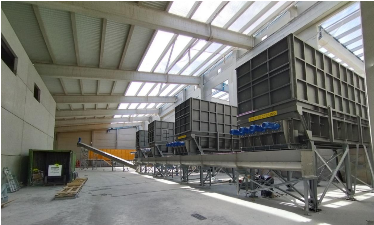
Tolvas de digesto
