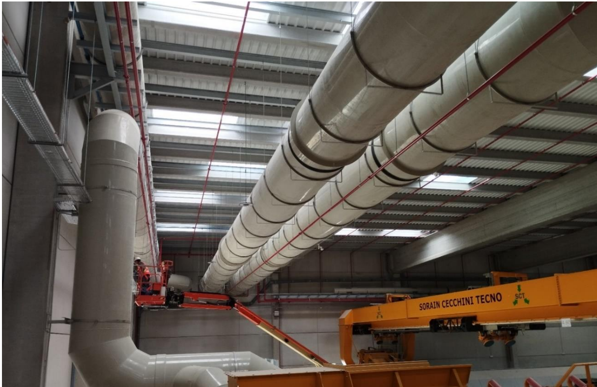
Desodorización y aire comprimido
