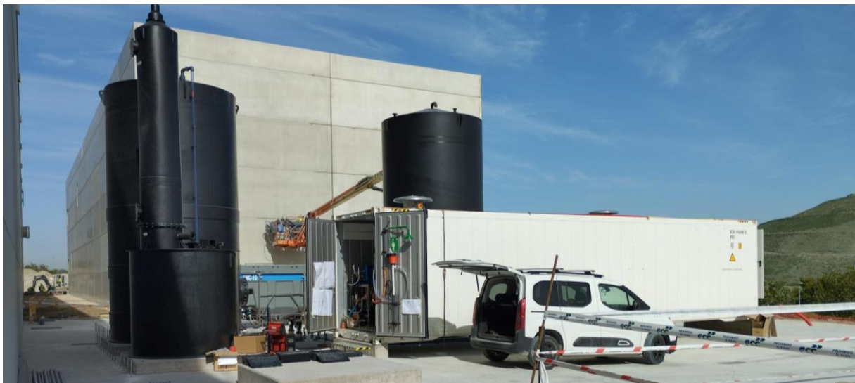
Depuradora y biofiltro.
