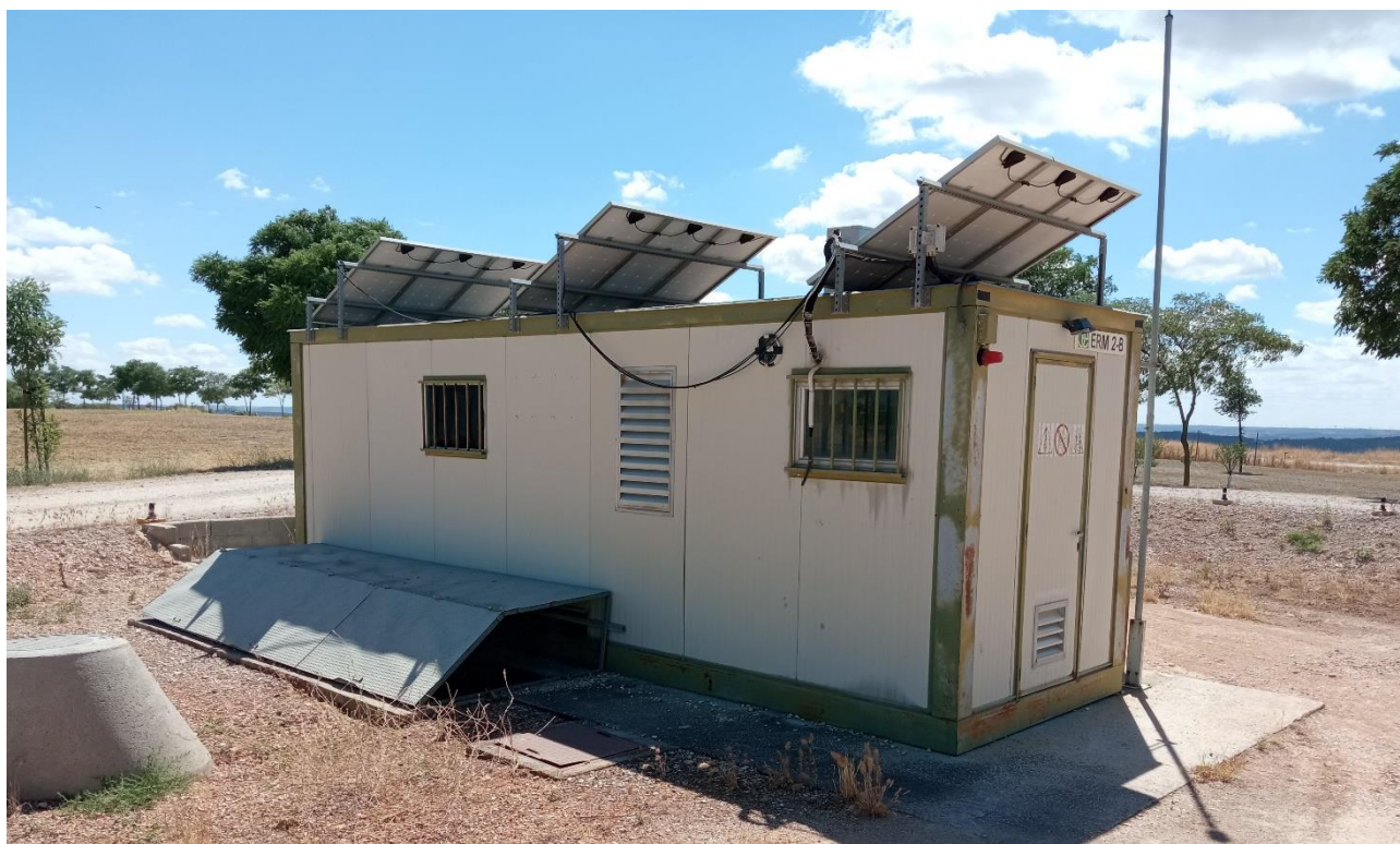
Estación de regulación de biogás en el vertedero clausurado
