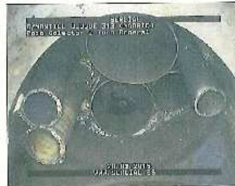
Foto: 2_2_10_A.jpg 9,6m, Acometida mal montada desde 10 hasta 02 horas
