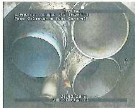
Foto: 2_2_18_A.jpg 96,4m, Acumulada mal montada desde 10 hasta 02 horas
