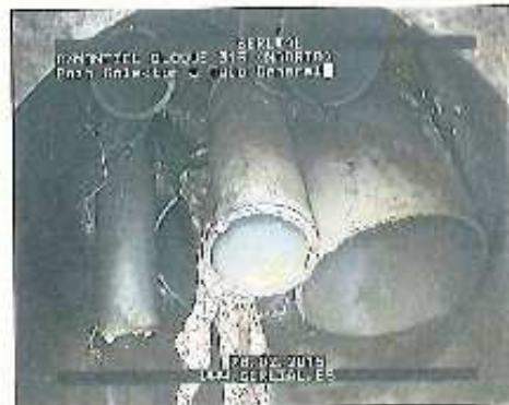
Foto: 2_2_6_A.jpg 2,0m, Acometida mal montada desde 10 hasta 02 horas
