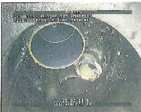
Foto: 2_2_13_A.jpg 20,7m, Acomodada mal montada desde 10 hasta 02 horas
