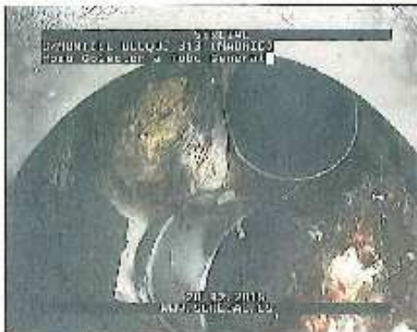
Foto: 2_2_19_A.jpg 41,4m, Acomodía mal montada desde 10 hasta 02 horas
