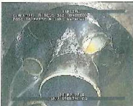
Foto: 2_2_17_A.jpg 92,6m, Acumulada mal montada desde 10 hasta 07 horas
