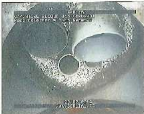
Foto: 2_2_15_A.jpg 79m, Acumulada mal montada desde 10 hasta 07 horas
