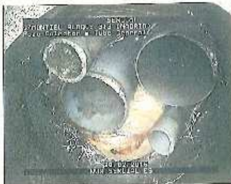
Foto: 2_2_8_A.jpg 5,5m, Acometida mal montada desde 10 hasta 02 horas
