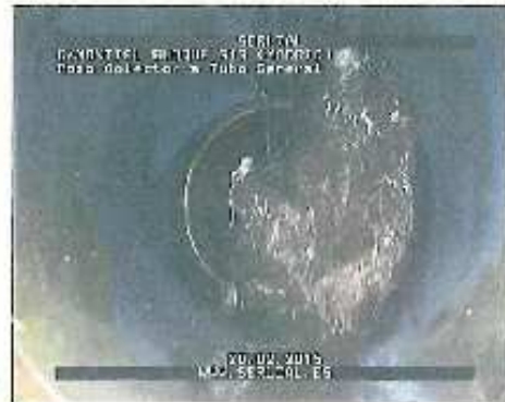
Foto: 2_2_20_A.jpg 41,4m, Obstrucción por raíces interiores desde 12 hasta 07 horas. Reducción de sección 60 %
