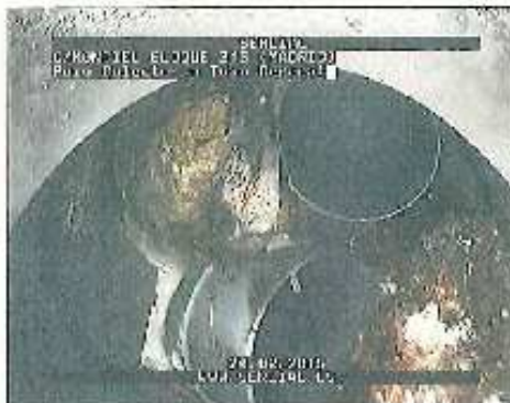
Foto: 2_2_20_B.jpg 41,4m, Obstrucción por raíces interiores desde 12 hasta 07 horas. Reducción de sección 80 %
