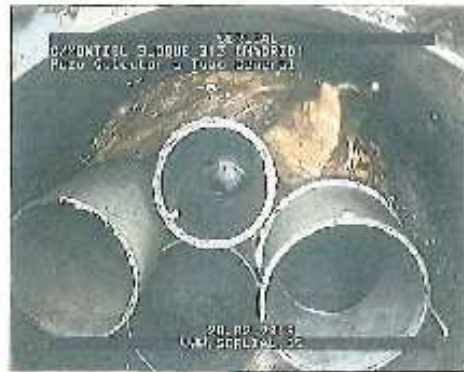
Foto: 2_2_12_A.jpg 15,2m, Acomodada mal montada desde 10 hasta 02 horas
