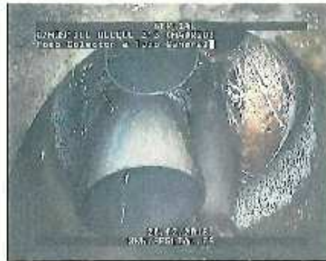
Foto: 2_2_16_A.jpg 90,2m. Acumulada mal montada desde 10 hasta 02 horas
