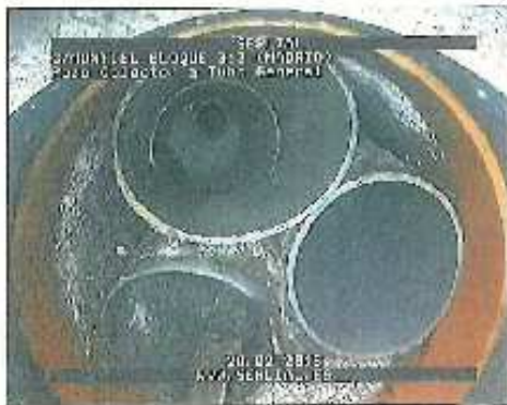
Foto: 2_2_11_A.jpg 12,7m, Acomodada mal montada desde 10 hasta 02 horas
