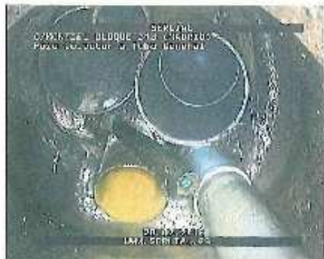
Foto: 2_2_14_A.jpg 24m, Acomodada mal montada desde 10 hasta 02 horas
