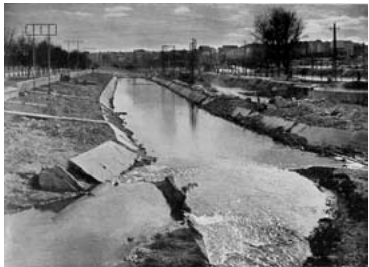
16.- Hacia 1946. Estado de deterioro de la canalización primitiva del Manzanares en los años 40.
